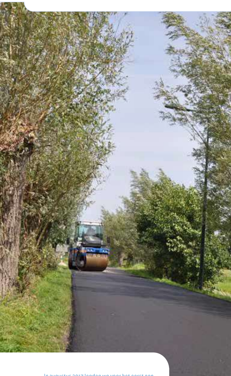
In augustus 2017 legden we voor het eerst een deklaag van 100% gerecycled asfalt aan op een rijbaan voor gemotoriseerd verkeer in Ouderkerk aan den IJssel.
